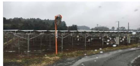
茨城県霞ヶ浦シェアリング発電所
