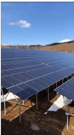
岩手県メガ発電所
